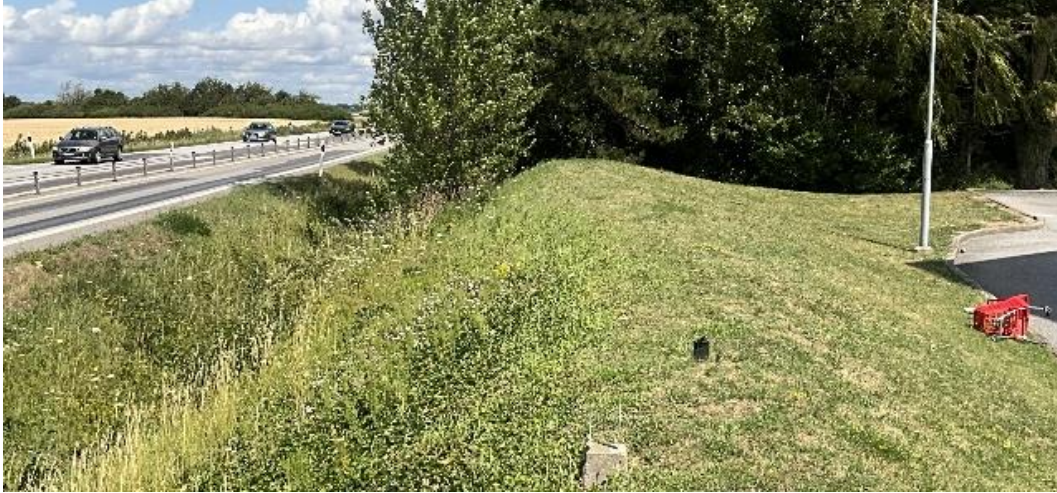
Figur 7. Objekt 3. Torkstressad grässlänt intill vägdikey.
